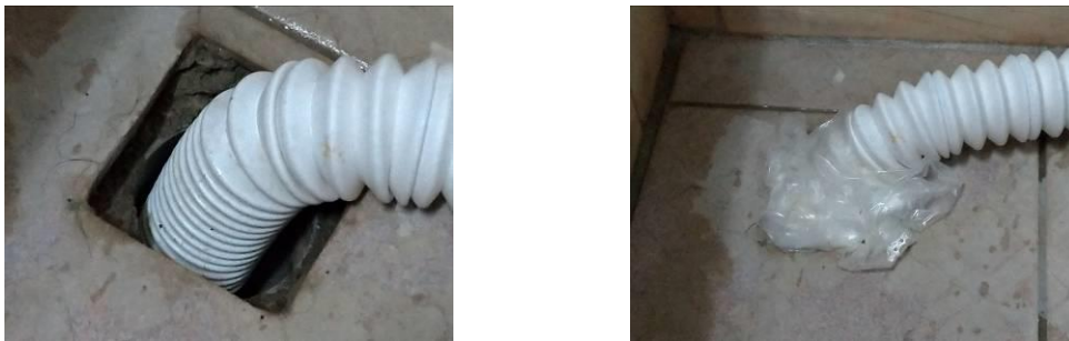
圖 40 排水四方孔旁原縫隙裸露(左圖)利用塑膠袋堵住(右圖)
