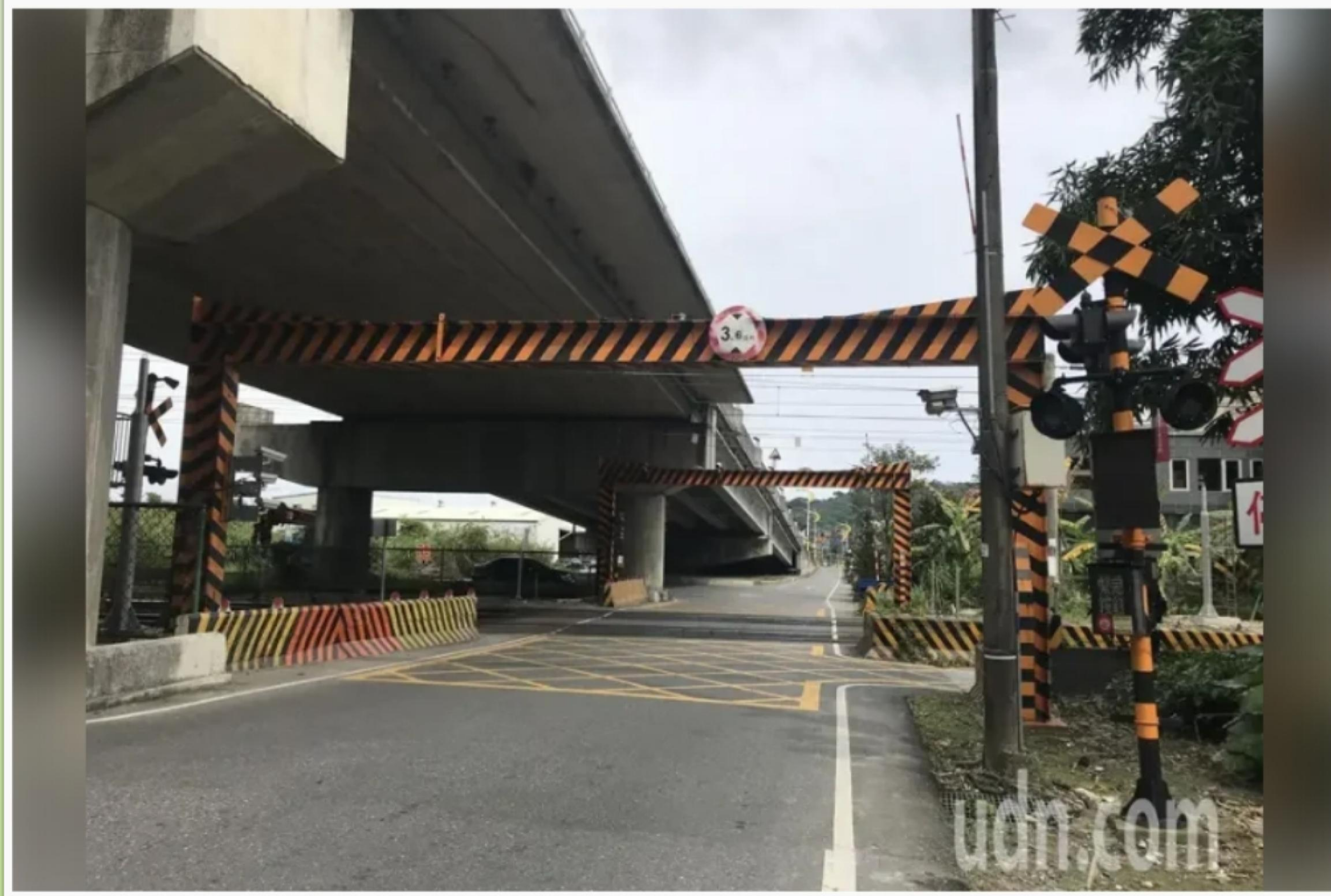
花蓮地區火車供電系統今天中午突然發生異常，4個平交道柵欄故障，其中豐川平交道已在下午1時40分修復。記者王燕華 / 攝影
