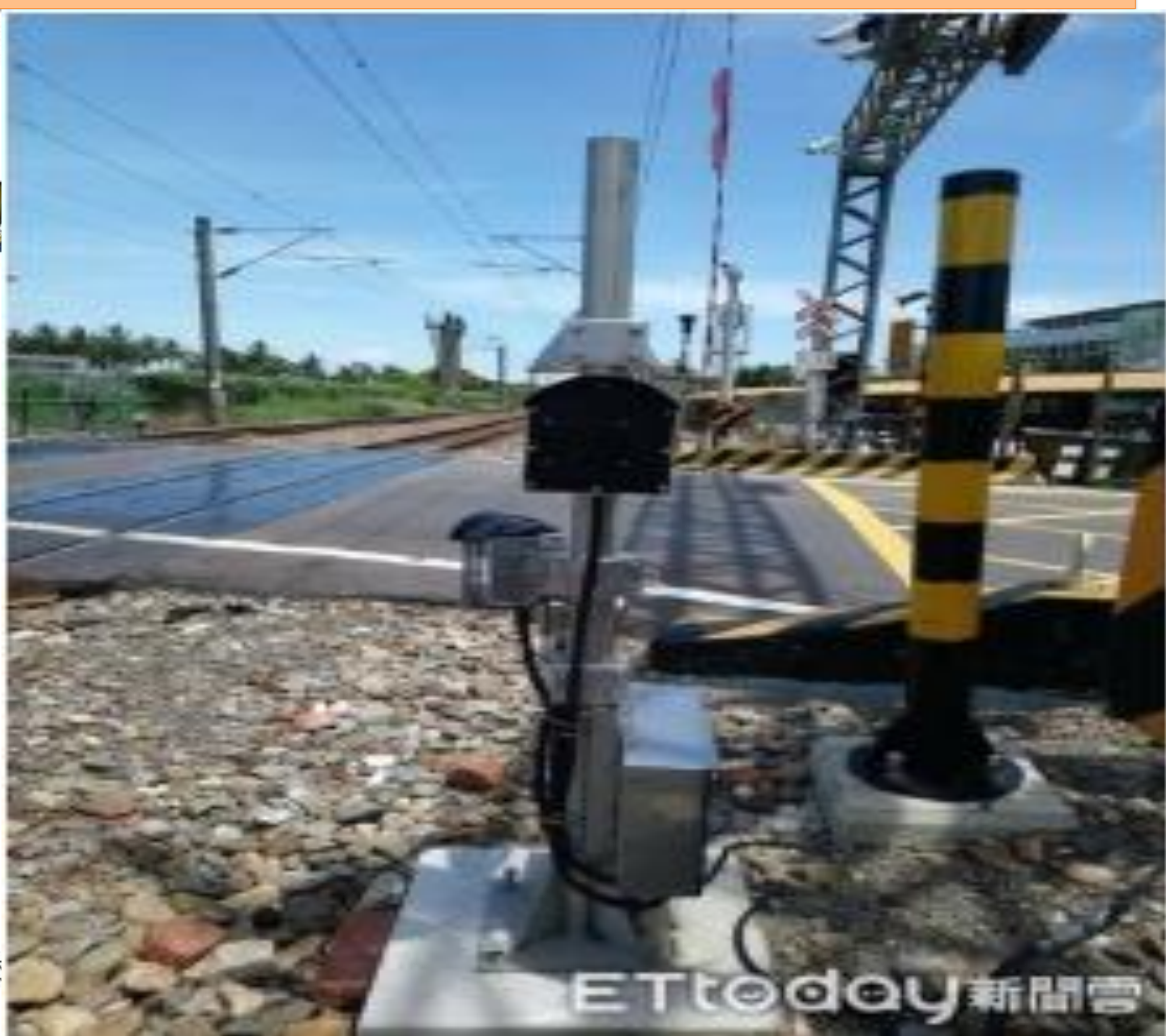
▲台鐵花費8億裝設平交道偵測器。(圖/台鐵局提供)
