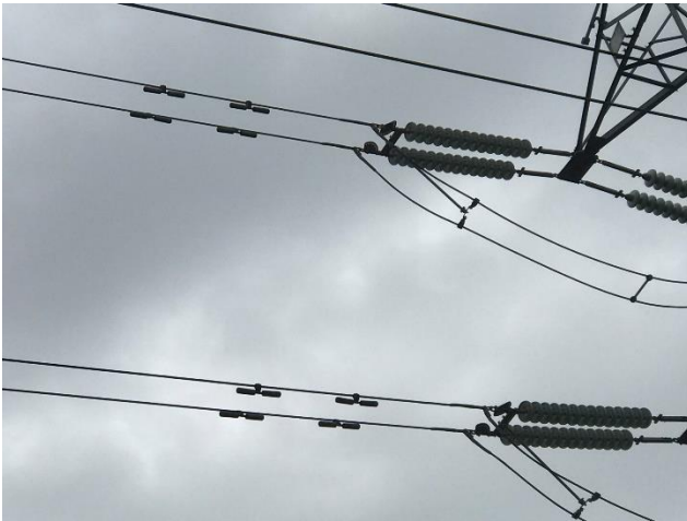
圖一：高壓電纜線
