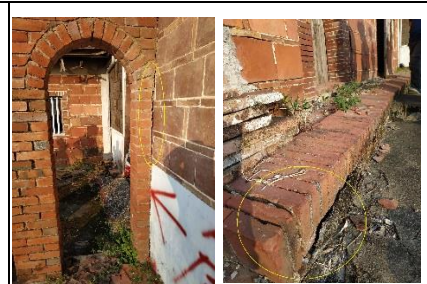
圖8-5：多處牆面與地磚，發生擠壓龜裂與隆起現象。
